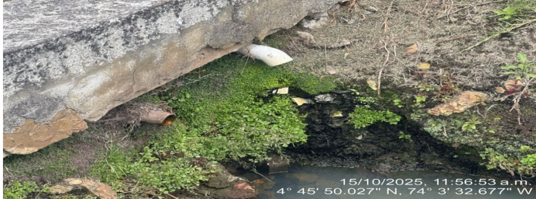
Fotografía 8. Tubería de descarga – Canal artificial de la carrera 68
