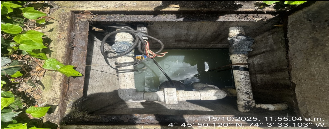
Fotografía 6. Caja previa a salida – electrobomba para descarga sobre canal artificial de la carrera 68.
