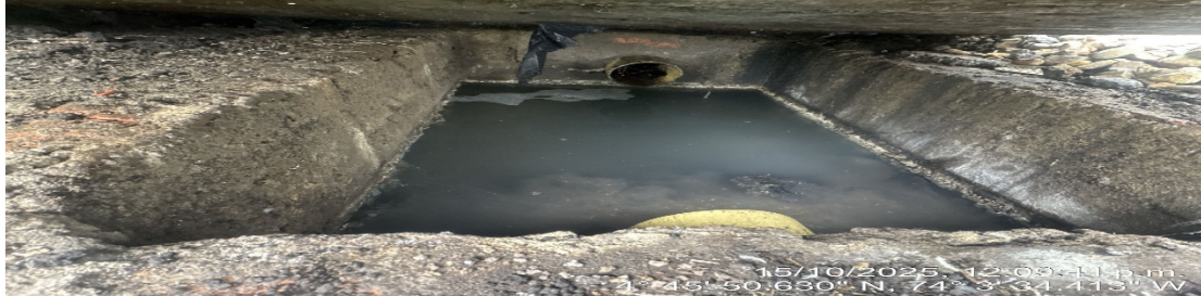
Fotografía 2. Trampa de Grasas 1 – Ubicada en casa 2
